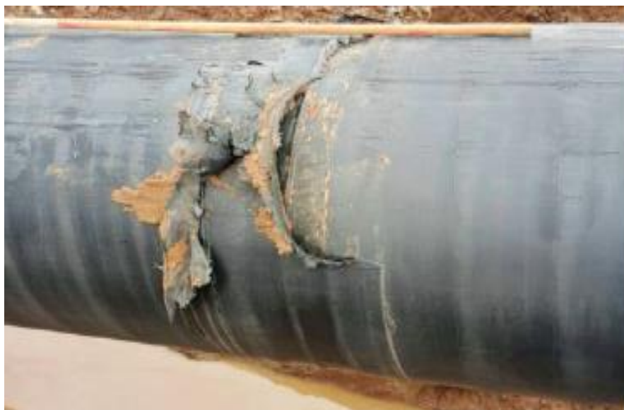
Рис. 1. - Нарушение изоляции трубопровода при нарушенной геометрии ствола скважины (УБКУА 0001-207-К-У03-01743-2018 14-ТСИБ/РЭН/1-01.2018 МН Усть - Балык - Курган - Уфа - Альметьевск)
